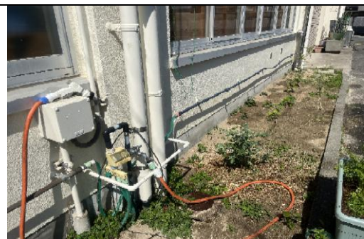
既設自動散水装置
